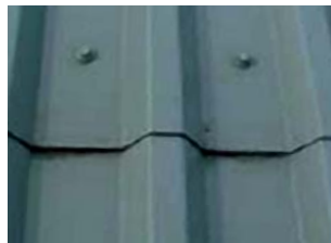
Dach mit Colorcoat HPS200® mit Galvalloy® nach sieben Jahren.
