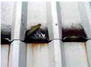
Dach mit Standard-Plastisol mit tauchverzinktem Stahl nach sieben Jahren.
