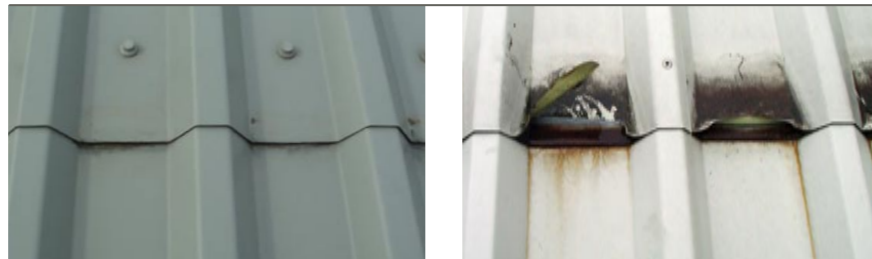
Dach mit Colorcoat HPS200® auf Galvalloy® Trägermaterial nach 7 Jahren
